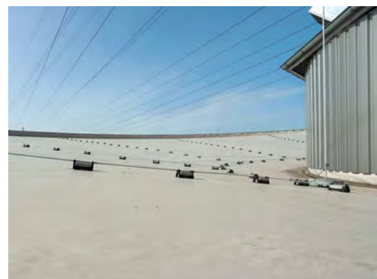
Das Dach wird von einer 4 mm dicken Blechmembran getragen, die auf Zug vorgespannt war
